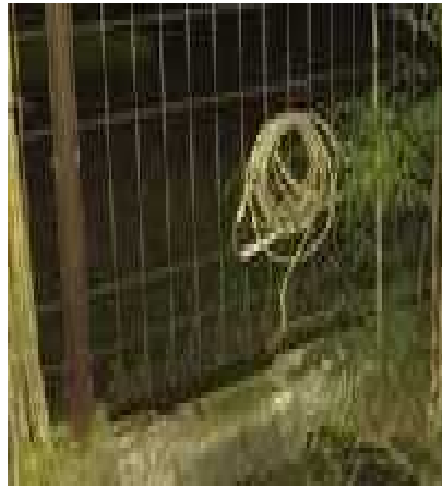
Gambar2 Perkabelan lampu penerangan jalan yang rusak.
